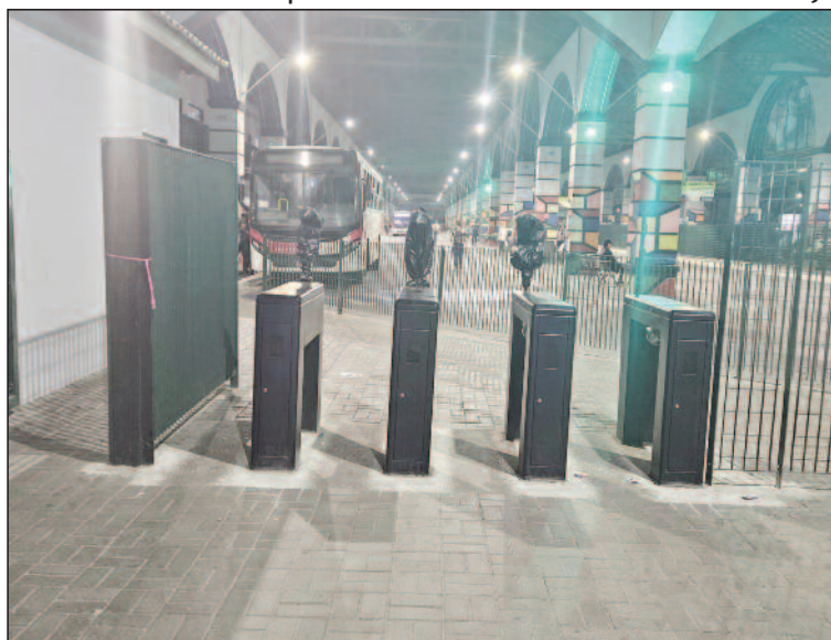
Equipamentos foram instalados, mas seguem sem uso até o momento
