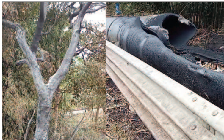
Chamas atingiram novamente tubulação da Sabesp no último domingo
