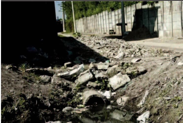
25 mil moradores de Ribeirão não têm coleta de esgoto
